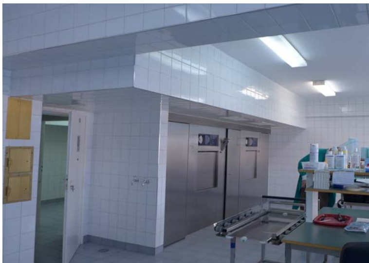
Zdjęcie 1 – Widok pomieszczenia sterylizatorów od strony brudnej
