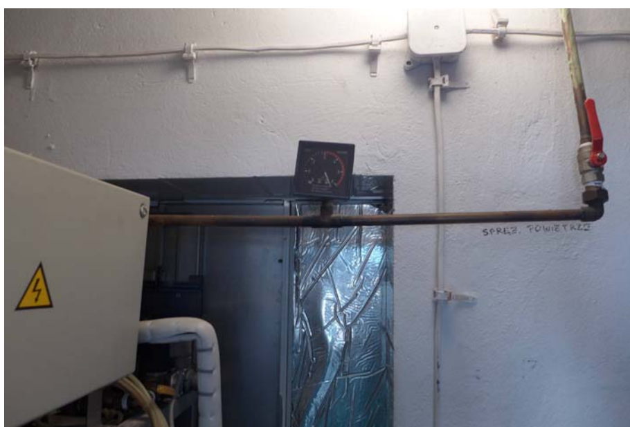
Zdjęcie 7 – miejsce poboru sprężonego powietrza
