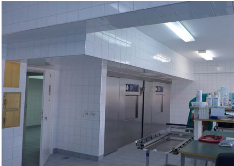
Zdjęcie 1 – Widok pomieszczenia sterylizatorów od strony brudnej
