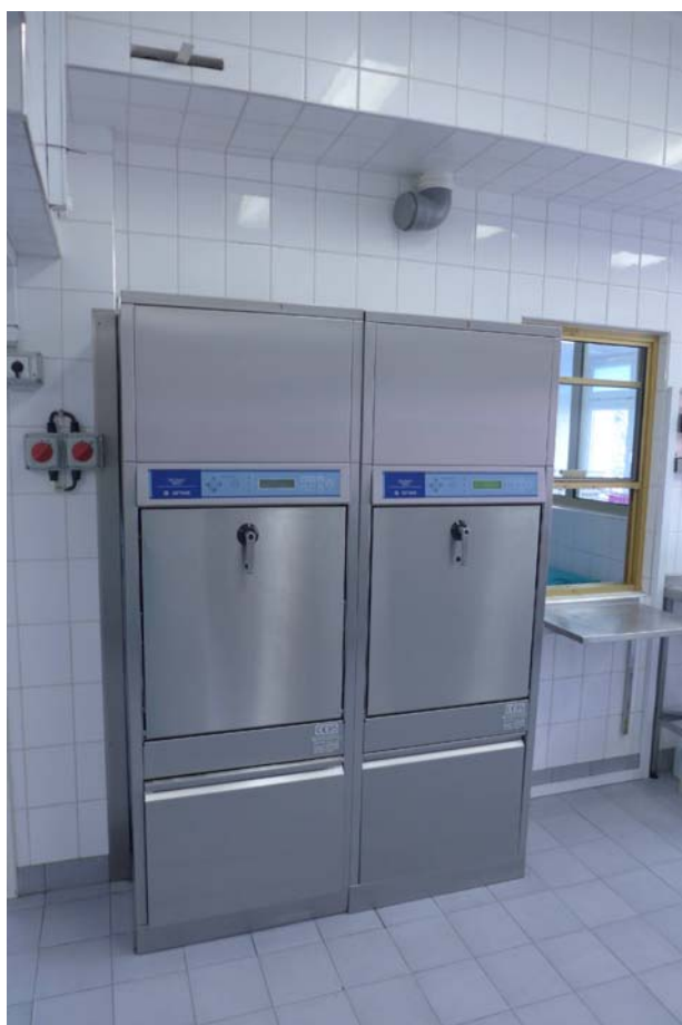
Zdjęcie 3 – Centralna sterylizatornia – widok myjek od strony brudnej
