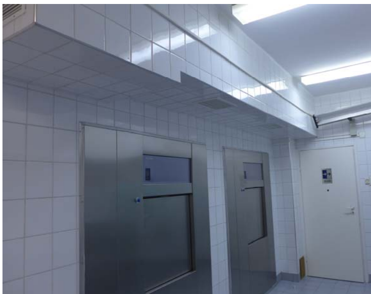
Zdjęcie 2 – Widok pomieszczenia sterylizatorów od strony czystej
