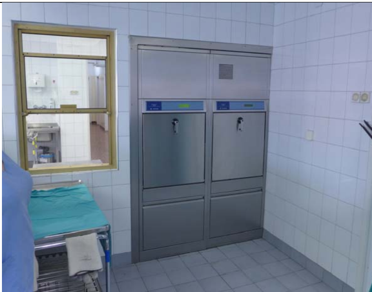
Zdjęcie 4 – Centralna sterylizatornia – widok myjek i okna podawczego od strony czystej
